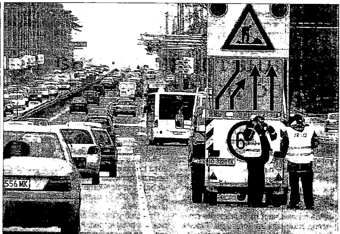
Работници с камион започнаха да поставят знаци за ограничаване на движението по „Цариградско шосе“ вчера. В началото на април започва ремонт на един от основните софийски булеварди. СНИМКА: ЙОРДАН СИМЕОНОВ
